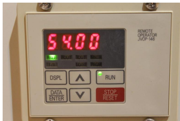
図 7 ポンプモータ制御パネル
