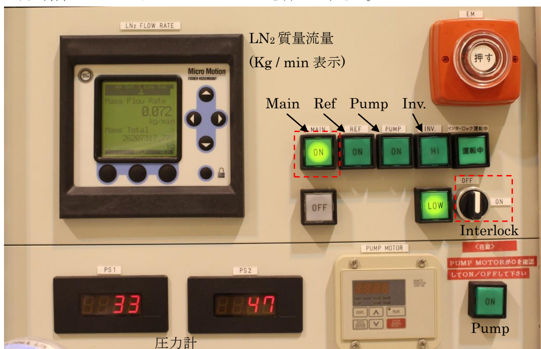
図 2 高効率結晶光学素子冷却装置 制御コントローラー 操作部（定常運転前）
